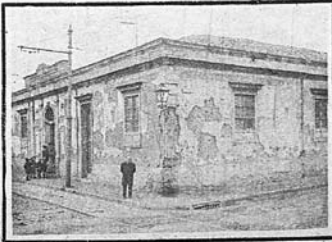
La fachada por la calle de Gálvez, mostrando el estado vergonzoso de deterioro, que se encuentra el edificio.
